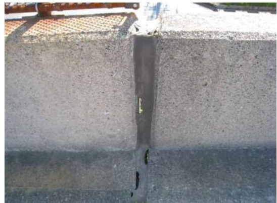
シーリング材の劣化状況
