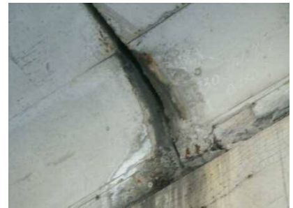
橋梁床版 裏面の劣化
